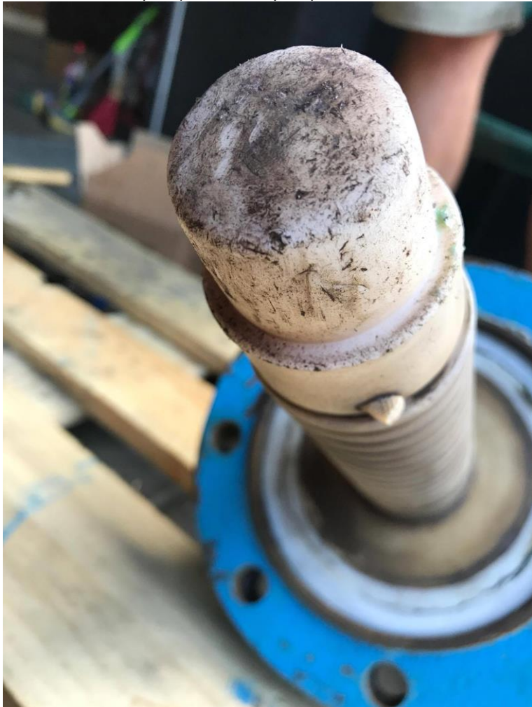
Widoczne uszkodzenia grzyba zaworu
